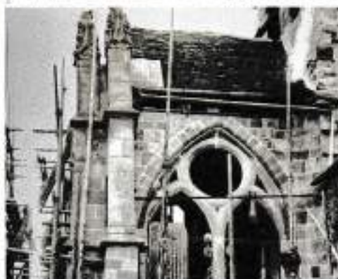
État avant travaux et reconstruction du croisillon Sud en 1936 avec matériel, sapine, échafaudage de l'entreprise Feiss et Dupuis.
